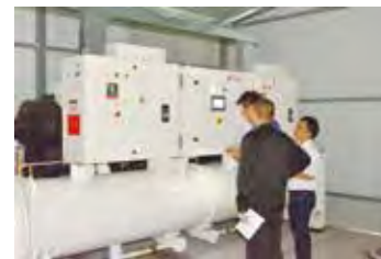
螺桿冰水主機
