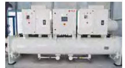
螺桿冰水主機
