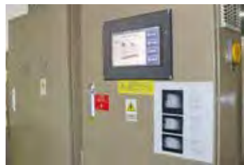
磁懸浮冰水主機
