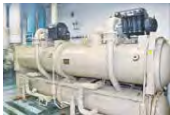
磁懸浮冰水主機
