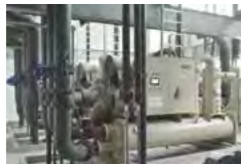
螺桿冰水主機
