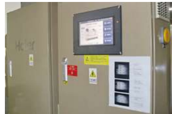
磁懸浮冰水主機
