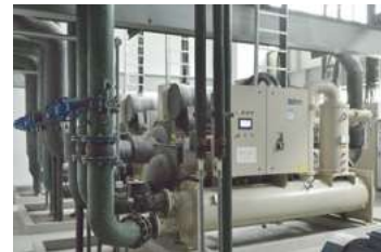
螺桿冰水主機
