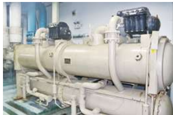
磁懸浮冰水主機
