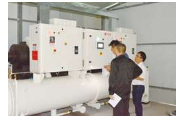
螺桿冰水主機
