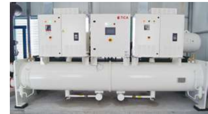
螺桿冰水主機
